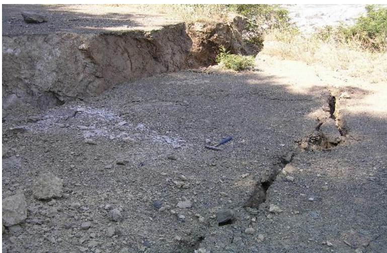
Fotografía IV-3 Falla y agrietamiento, Agosto 2004, MHBB
