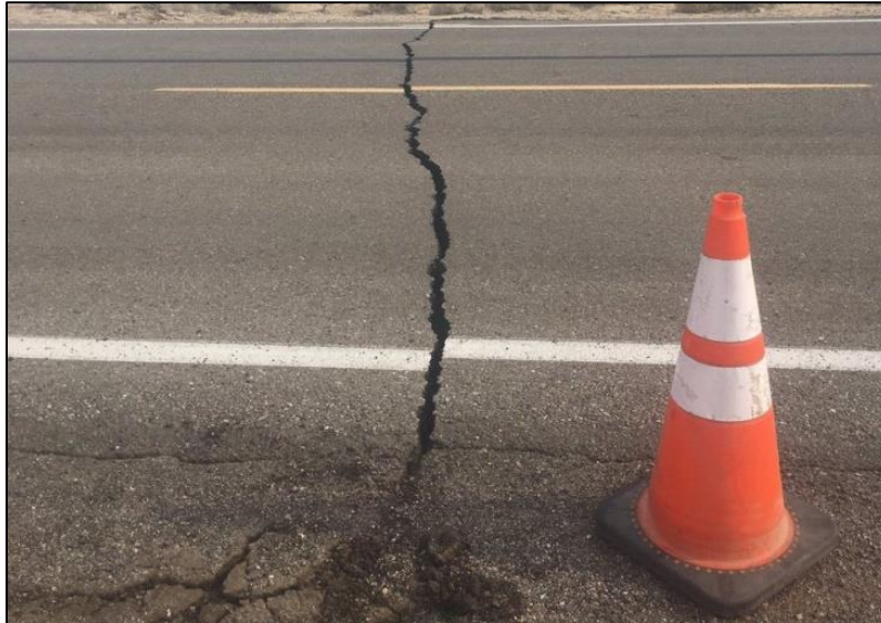
Fotografía II-16. Agrietamiento en autopista de Estados Unidos. Fuente: (Staff, Guerin, MacNary, & Fonseca, 2019)
