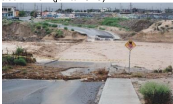
Pérdidas de tramo de carretera por deslizamientos, arrastre y exceso de agua durante el Huracán Alex
