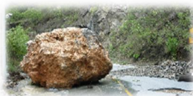
Huracán Alex, julio del 2010, deslizamiento de bloque.
