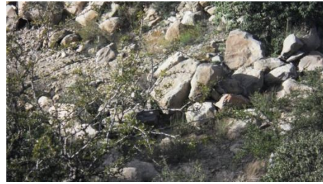
Material desprendido de la parte alta del Cerro de la Mota
