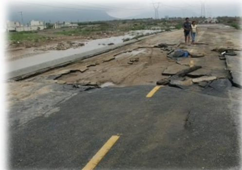
Av. Las Torres y Col. Buganvillas dañada por la venida de agua y arrastre de materiales.
