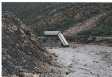
Deslizamiento de material por pendientes y Infraestructura ferroviaria por el Huracán Alex
