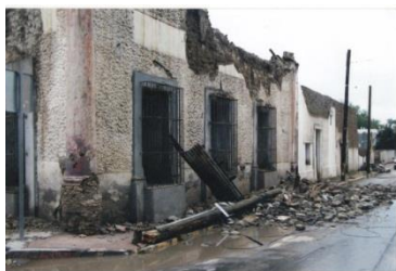
Derrumbe de una casa por Efecto de Huracán Alex (julio/2010).
