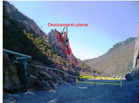
Fig. 1.2 La posición de estratos e intenso fracturamiento de la roca ponen en riesgo la vía de comunicación.
